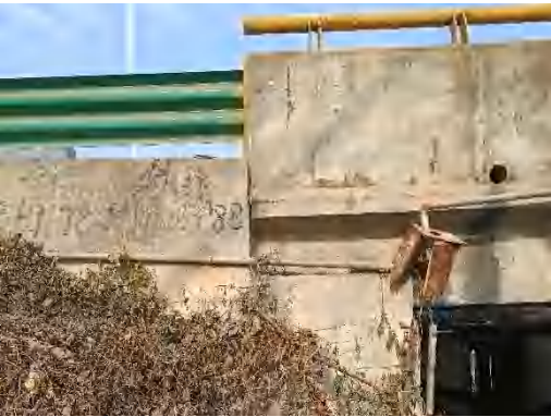
护栏破损露筋
