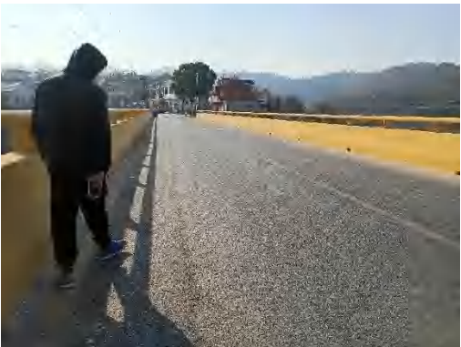
桥面不平整局部凹陷
