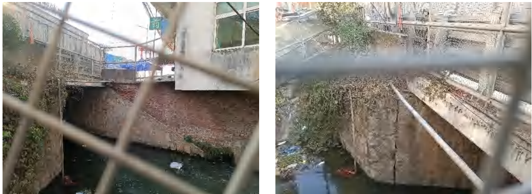
桥台砌体风化、裂缝
