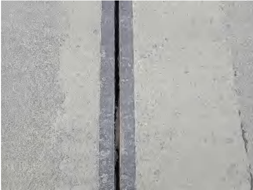
伸缩缝止水带破损
