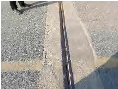
伸缩缝锚固区破损
