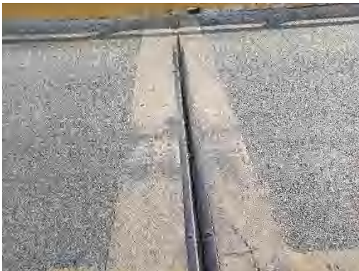
伸缩缝止水带破损
