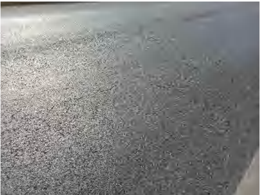
桥面铺装裂缝
