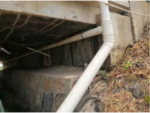
桥台台帽渗水
