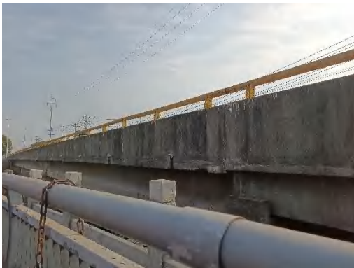
泄水管破损、流水侵蚀
