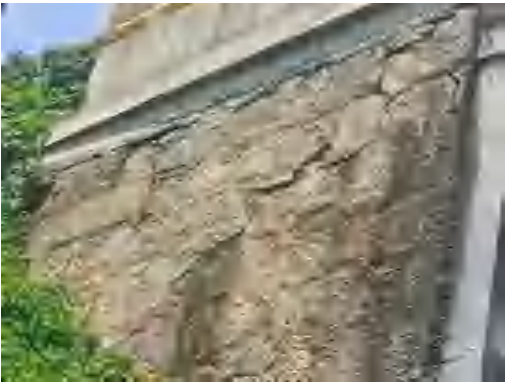
桥台侧墙斜向裂缝
