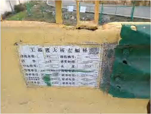
护栏混凝土破损
