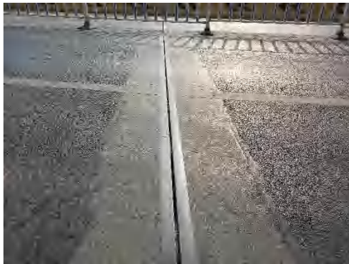
伸缩缝堵塞、止水带破损
