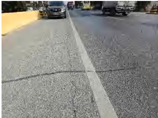
纵向贯通裂缝
