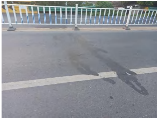
桥面铺装裂缝
