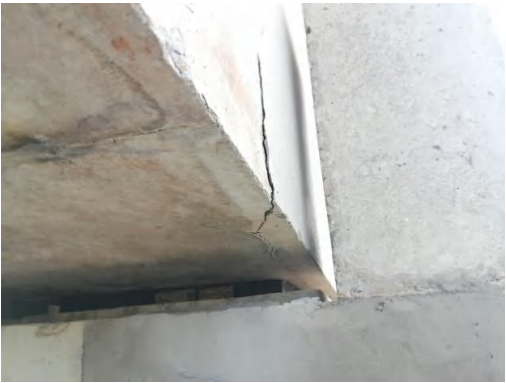
T 梁腹板破损裂缝
