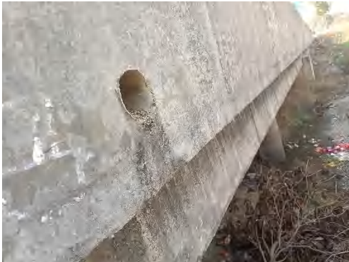
泄水管未伸出梁体
