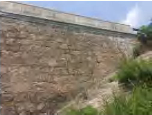
桥台侧墙灰缝脱落
