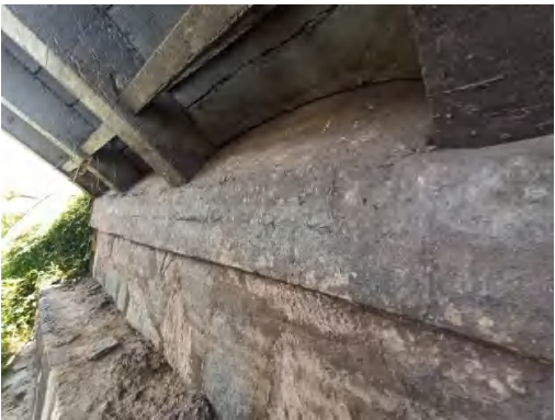
桥台风化露骨
