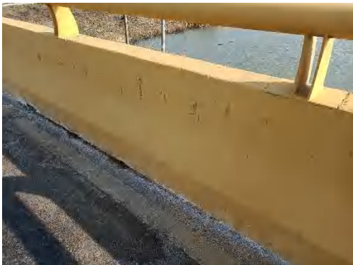
护栏表面破损露筋
