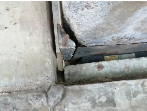
T 梁腹板破损露筋
