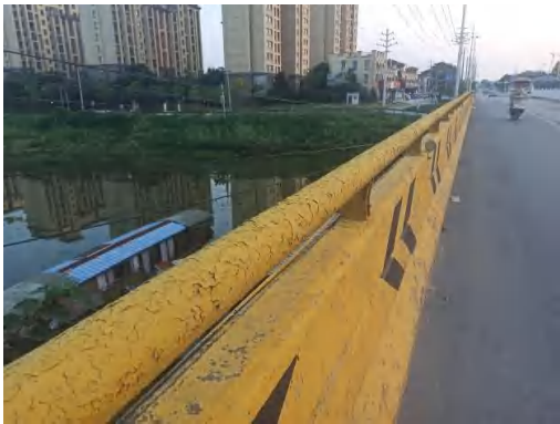
护栏钢扶手锈蚀
