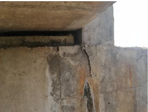
桥墩盖梁渗水混凝土侵蚀
