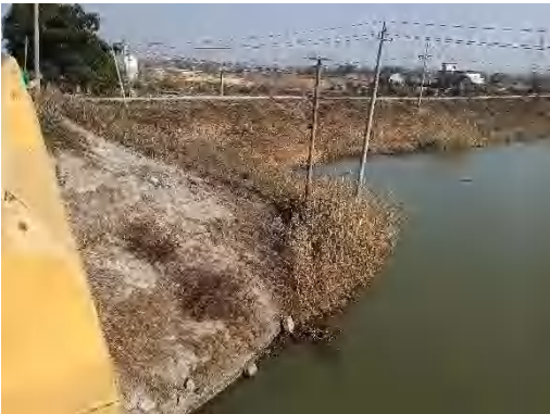
老桥锥坡破损杂草滋生
