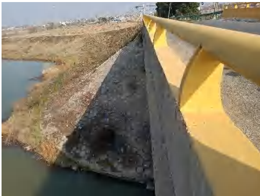
钢扶手轻微锈蚀
