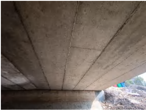
第三、四块板间铰缝松动
