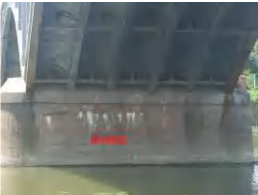
桥墩墩身析白
