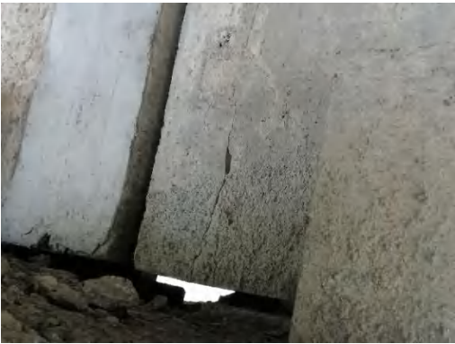
T 梁端部竖向裂缝
