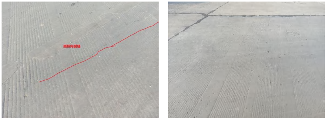
桥面铺装裂缝
